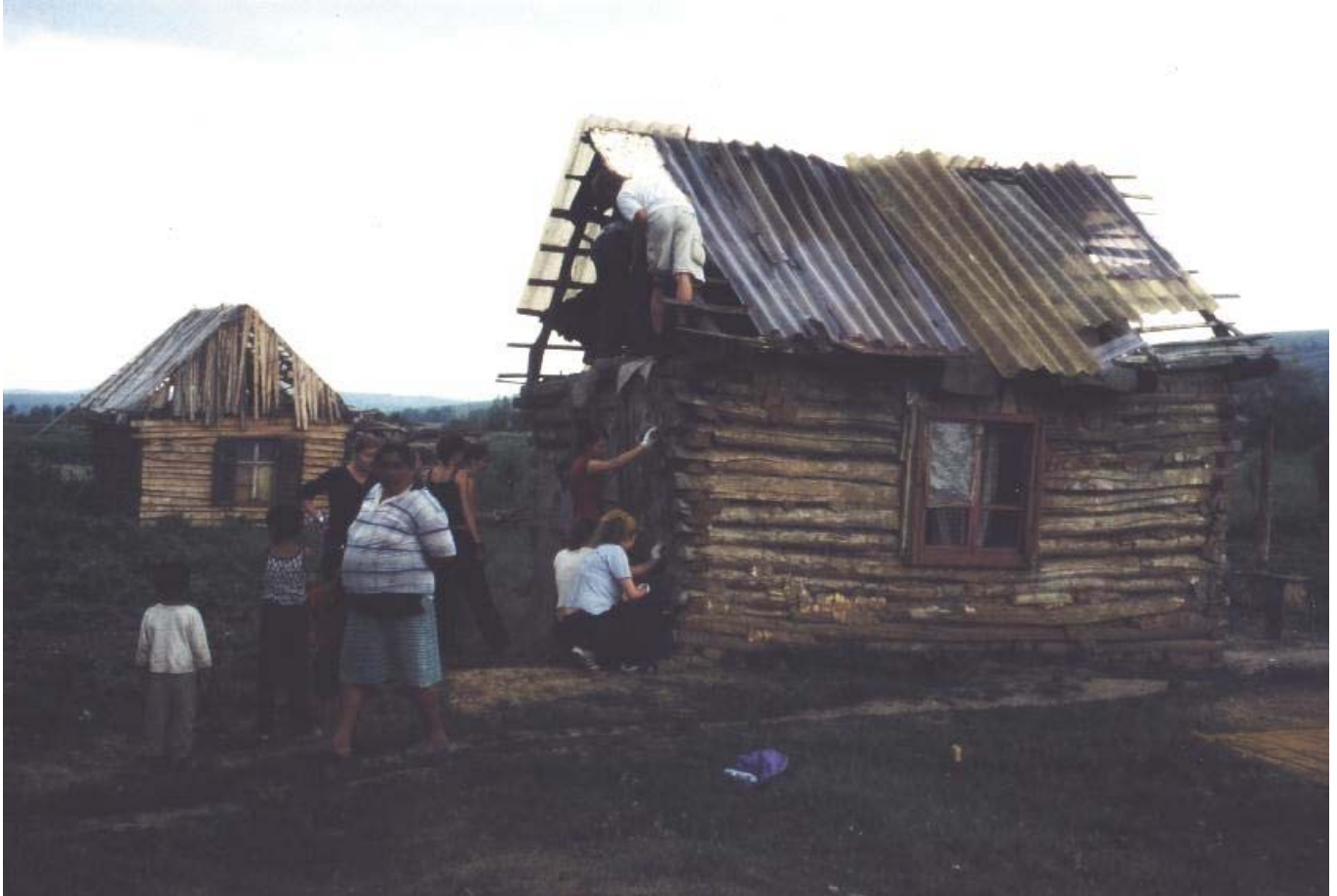
Zustand eines Einzimmer-Hauses vor der Instandsetzung
